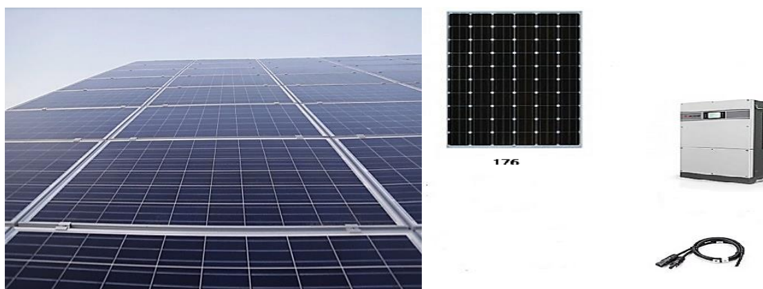
Рис. 1. Солнечная сетевая электростанция «GWS Energy»
