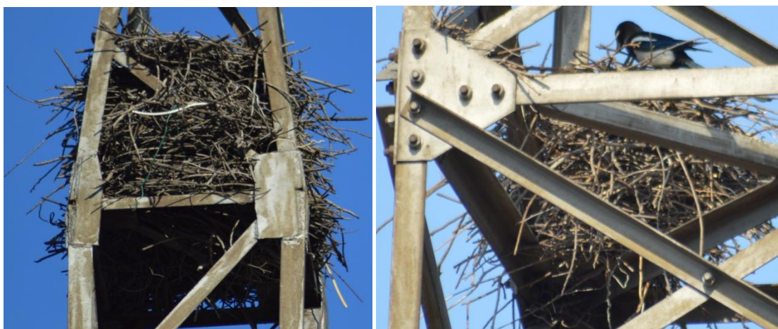
Рисунок – Гнезда сорок на металлических опорах ЛЭП
